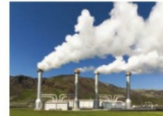
شکل ۶-۱۱. نیروگاه زمین گرمایی مشکین شهر - اردبیل
